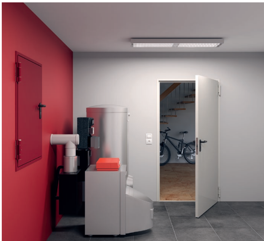
Drzwi wewnętrzne spełniające wymagania w zakresie ochrony przeciwpożarowej.
