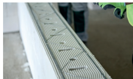
Nie można pominąć zbrojenia muru w żadnym fragmencie w którym jest ono wymagane.
