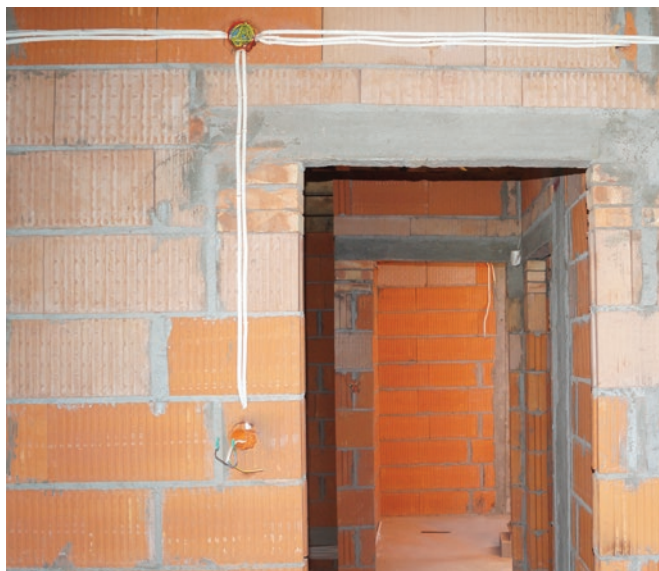
Przewód ułożony na uchwytach kablowych.
