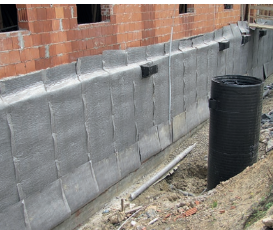
Ściana fundamentowa zabezpieczona matą drenarską, która odprowadza nadmiar wody gruntowej do sączków drenarskich zlokalizowanych u podstawy ściany fundamentowej.
