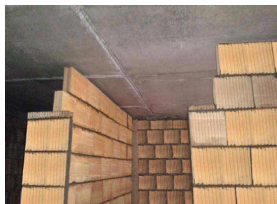
Ścianki działowe oddylatowane od stropu – rozwiązanie prawidłowe.
