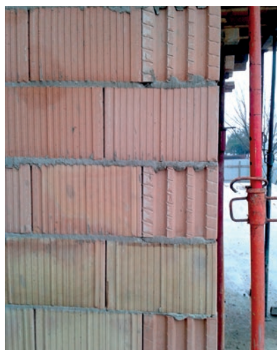
Nieprawidłowo wykonane naroże ściany z pustaków na pióro i wpust. Brak spoiny pionowej przyłączeni pustaków w narożu ściany (w miejscu gdzie nie ma zamka na pióro i wpust).
