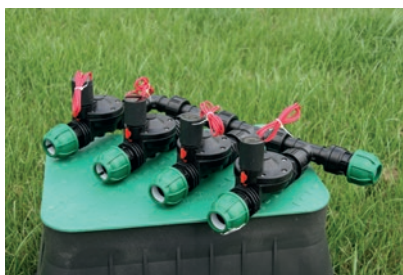
Elektrozawory otwierające przepływ wody w poszczególnych sekcjach systemu
