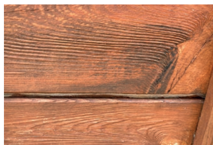
Odsłonięte surowe drewno pod wpływem skurczu po czasie
