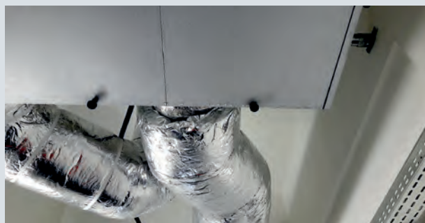
Kondensacja pary wodnej na obudowie centrali wentylacyjnej.
