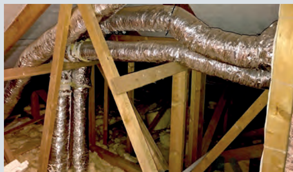
Instalacja wykonana z przewodów elastycznych izolowanych.
