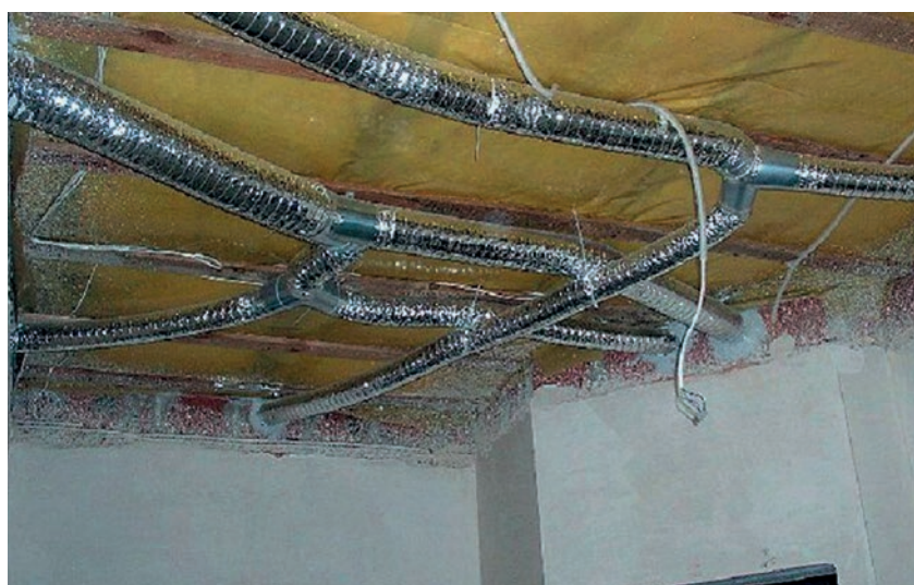
Przykład niewłaściwie położonych kanałów wentylacyjnych (źródło: https://budujemydom.pl/instalacje/wentylacja-i-klimatyzacja/a/11502-bledy-przy-wykonywaniu-wentylacji ; dostęp 24.04.2020)
