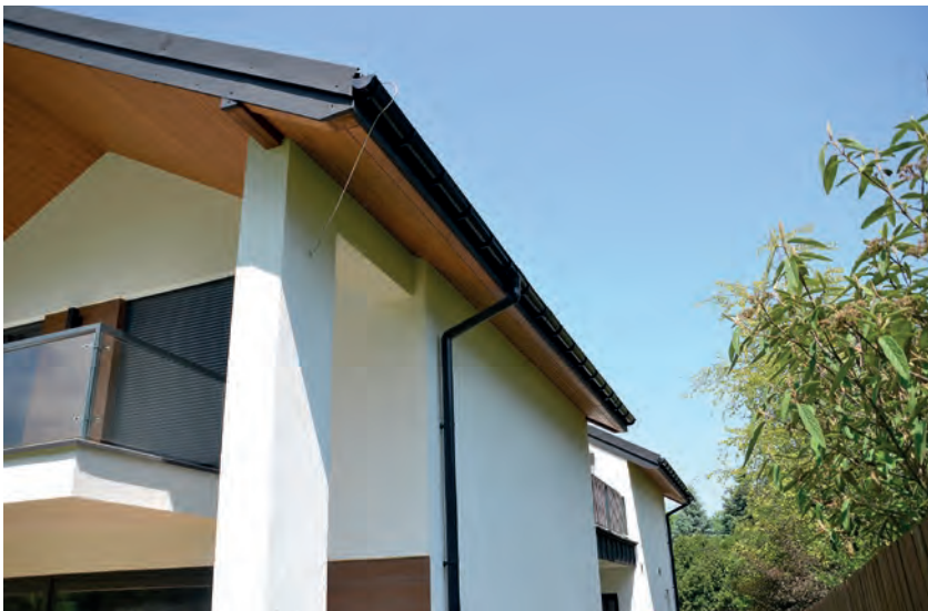
Okrągłe rynny PVC na nowoczesnym domu jednorodzinnym.
