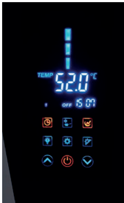
Panel sterownika pompy ciepła.
