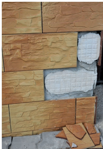
Błąd wykonawczy – pozostawione puste przestrzenie, metoda klejenia na tzw. „placki”.
