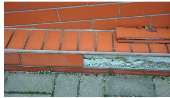
Brak izolacji przeciwwilgociowych spowodował erozję muru i odspojenie płytek.
